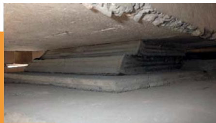
Daños en un aparato de apoyo
